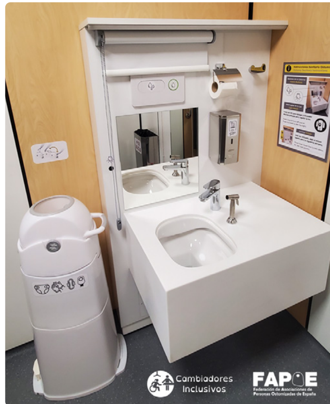
Imagen 2: sanitario de ostomía prefabricado con elementos y especificaciones propias para ser ubicado dentro de un cambiador inclusivo.
